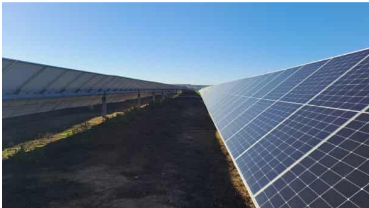
Kuva 39. Aurinkopaneeleja. (Taaleri Energia)
