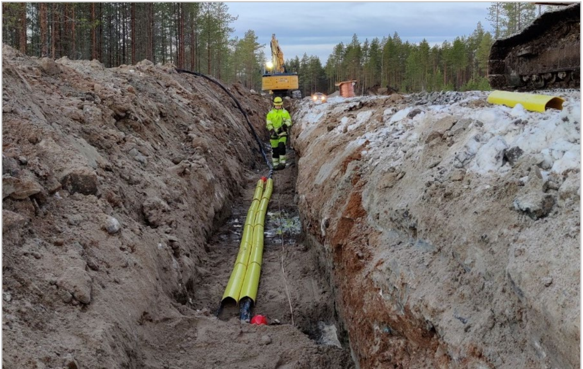
Kuva 38. Esimerkkikuva tuulivoimalan kaapeliasennuksista (Taaleri Energia Oy).
