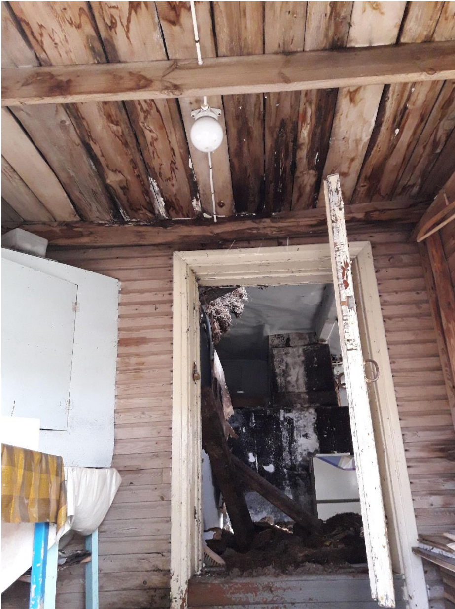
Kuva 3. Rakennuksen ulko-ovi ei ollut lukittu. Kuistin sisäkatossa näkyy vesivuotojen jälkiä ja sisempänä katto on romahtanut. Rakennus ei ole turvallinen.
