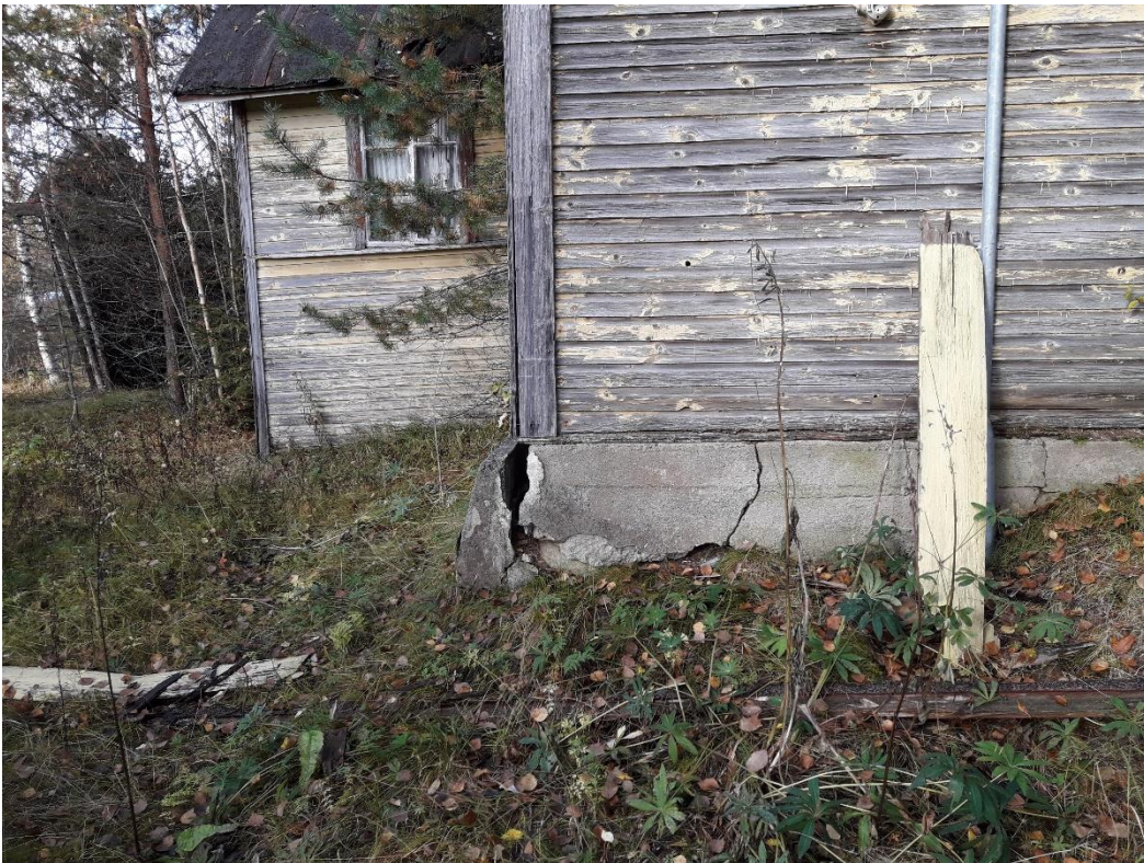
Kuva 2. Perustukset ovat liikkuneet murtuneet
