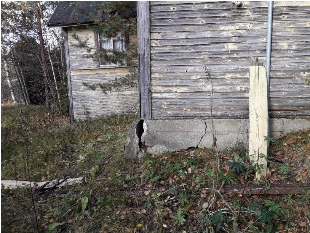
Kuva 2. Perustukset ovat liikkuneet murtuneet
